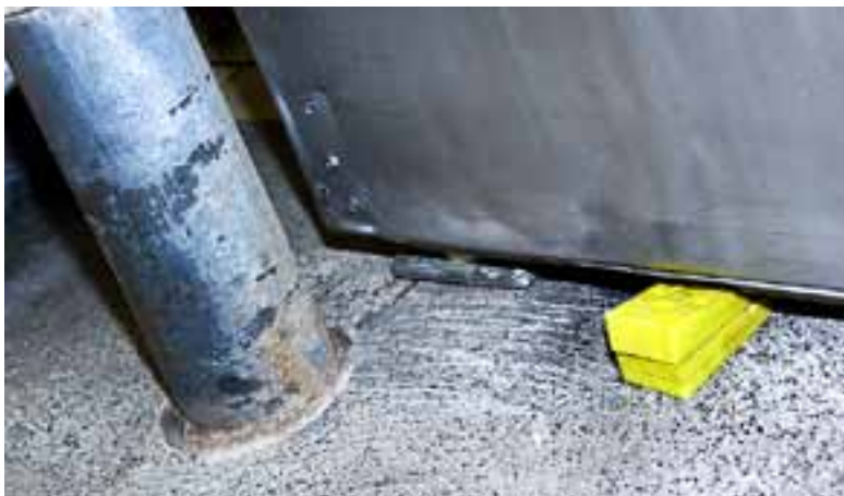
Med det samme Niels Conradsen opdagede den gule kile i brandporten, hev han fat i en medarbejder og forklarede, at det ikke var i orden.
