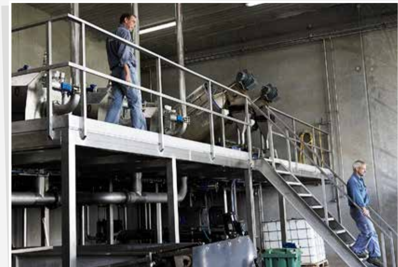
Scan-Hide har bygget sit eget anlæg til at for-rende spildevandet.
